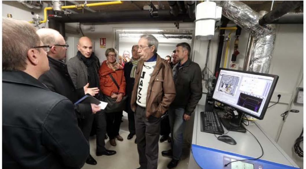
Ce mardi 7 février, la maison relais « L'Autre Toit » présentait son installation innovante de production d'énergie. Photos Ludovic LAUDE
